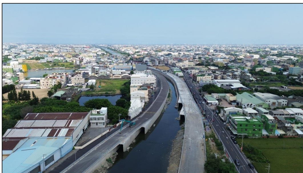
圖 5：洋仔厝溪堤岸道路第二標南北岸工程（上游段）道路箱涵施作情形
